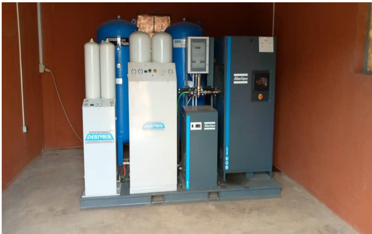
Centrale d'oxygène en extension de la première centrale existante
