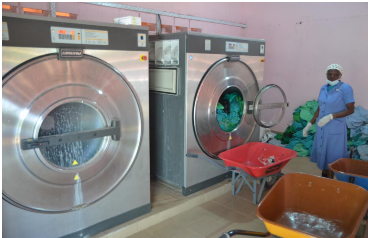
Deux machines à laver obtenu grâce à l'appui du gouvernement de Cantabria
